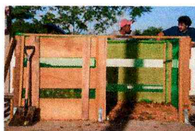
Compostagem por aeração forçada
