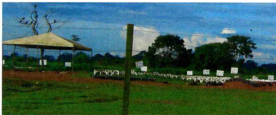
Figura 23 – Valas sépticas localizadas na UTRE.
